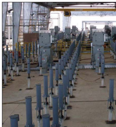
Slika 37. Elektromagnetni čekići na krovu elektrostatičkog filtera
